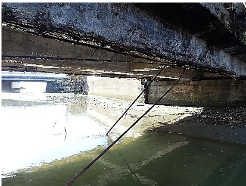
塩害劣化して鉄筋が破断した道路橋
